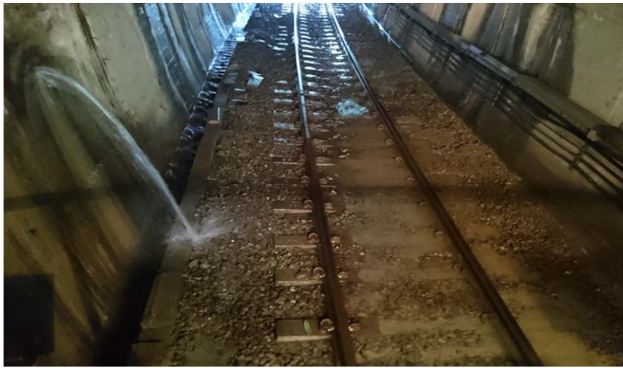
圖 3-27 集集支線中興隧道排水設施不良示意圖
