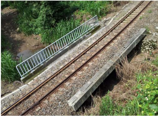
圖 3-35 曲線外軌側石碴不足
