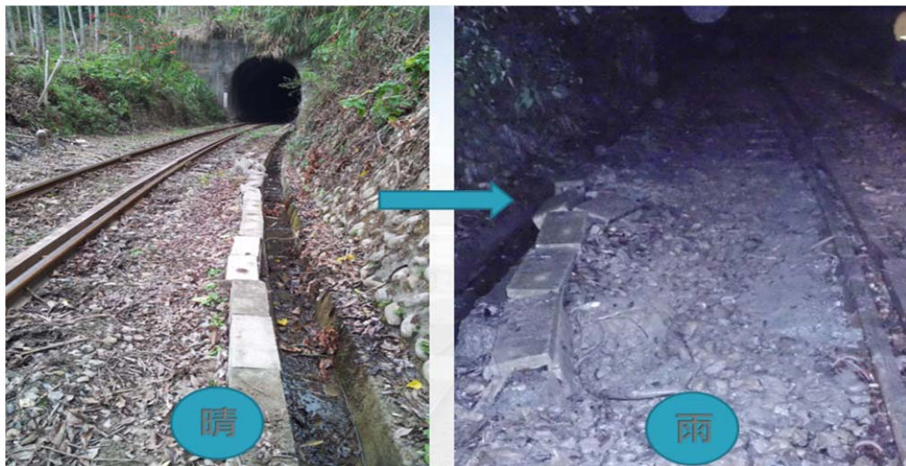
圖 3-26 集集支線 1 號隧道南口排水設施不良示意圖
