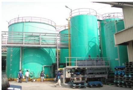
強冠公司廠區儲油槽設備
