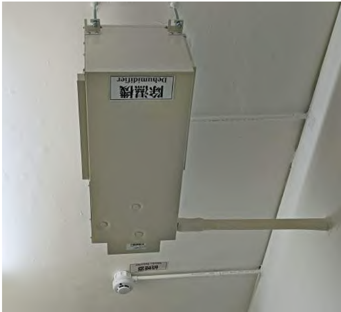
(除濕機設於天花板)
