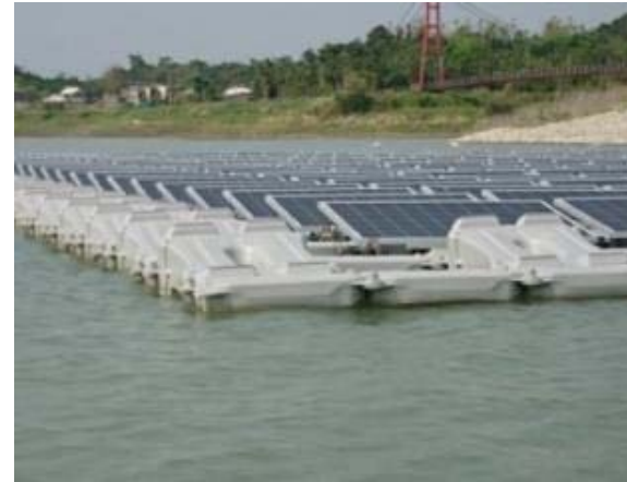
高雄阿公店水庫 (2.32 MW) 首例水庫 浮動式光電
