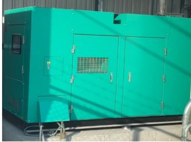
圖 3、備用電源發電機設備
