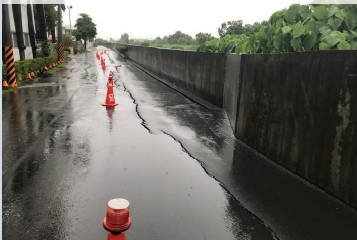
三爺溪九空橋下游左岸堤岸基脚淘刷
