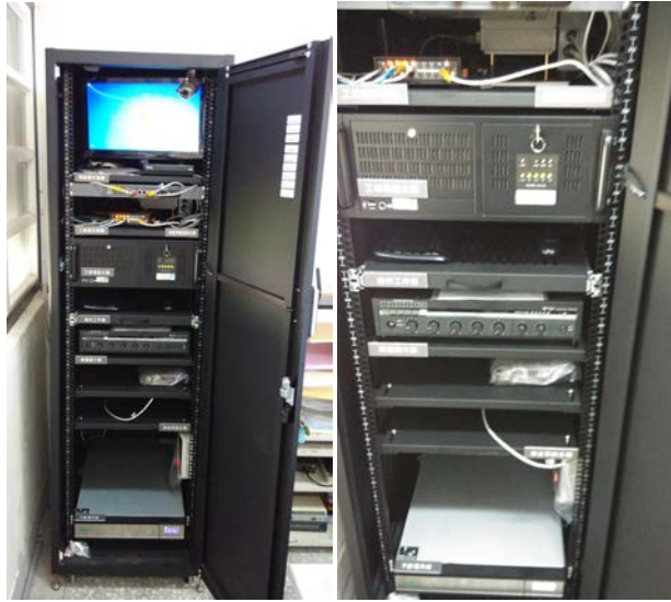
地震預警系統運算主機機櫃
