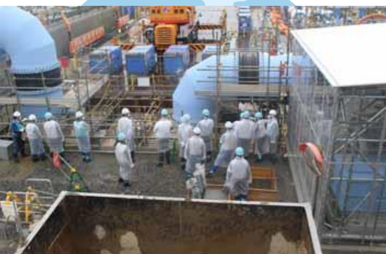
IAEA專案任務小組112年6月2日視察排放稀釋設備 (圖片來源：東京電力公司處理水入口網)
