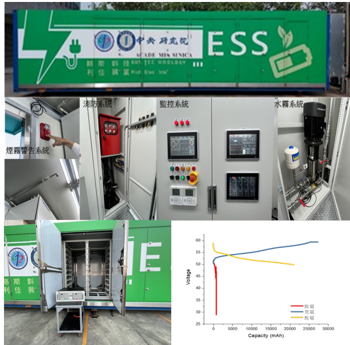
圖八、完成導入新型電芯建置具調頻與儲存複合功能之 MWh 大型儲能系統。
