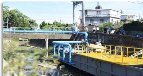
苗栗尖山下圳抽水至東興淨水場
