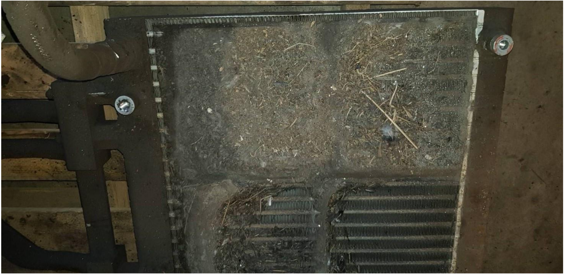
普悠瑪特檢拆卸之油冷卻器照片
