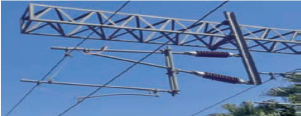
圖 1.29 懸臂組、小鋼件銹蝕情形
