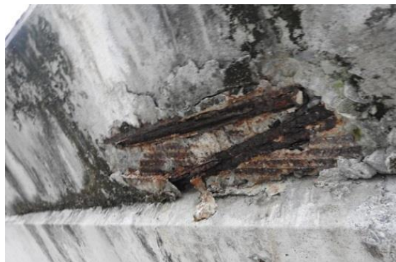
橋梁鹽害、混凝土開裂、 鋼筋鏽蝕、通洪斷面不足
