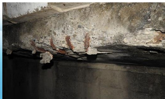
橋梁鹽害、混凝土剝落、 鋼筋嚴重鏽蝕
