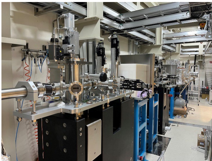
安裝完成的光束線設備。
