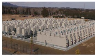
東北電力公司福島縣變電站，鈦酸鋰電池總容量為40MW/40MWh
