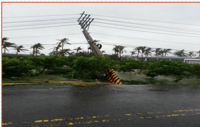
桿基破壞(電桿傾倒)
