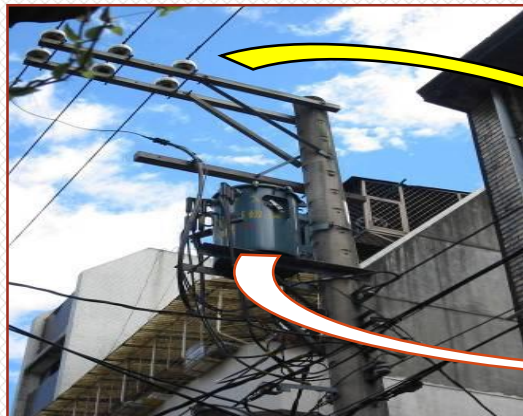
架空線路與變壓器
