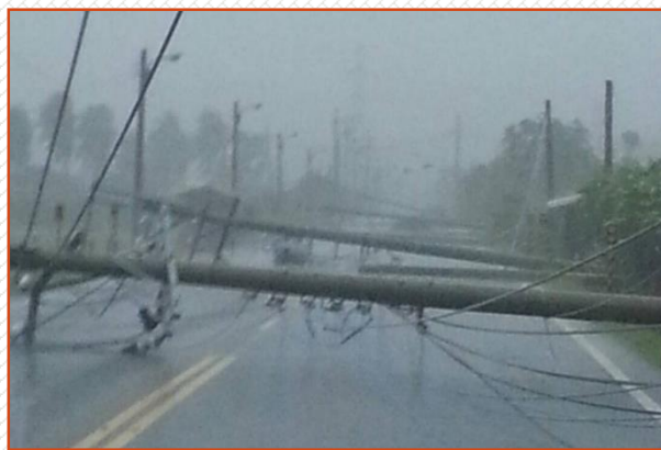
桿基破壞(電桿傾倒)
