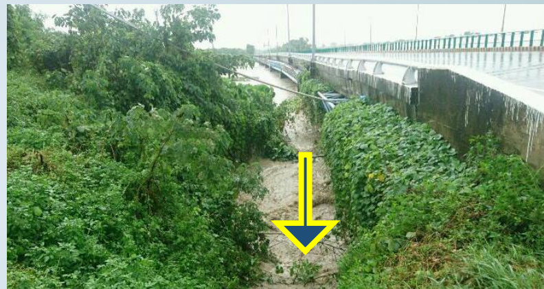
八掌溪橋下左岸堤防因水位持續高漲， 橋梁下堤防破損約40~50公尺。
