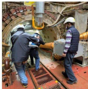
加強通風設備檢查
