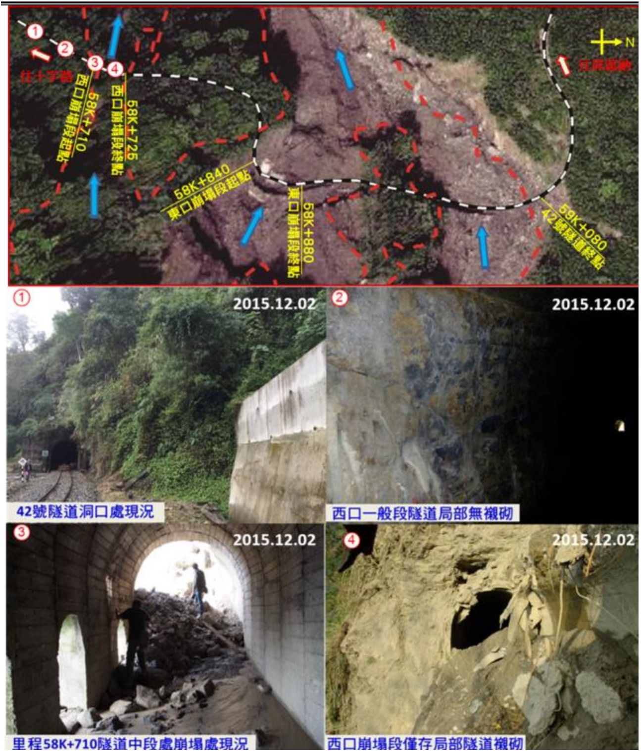
圖 2-2-2 42 號隧道西洞口崩塌地現況圖
