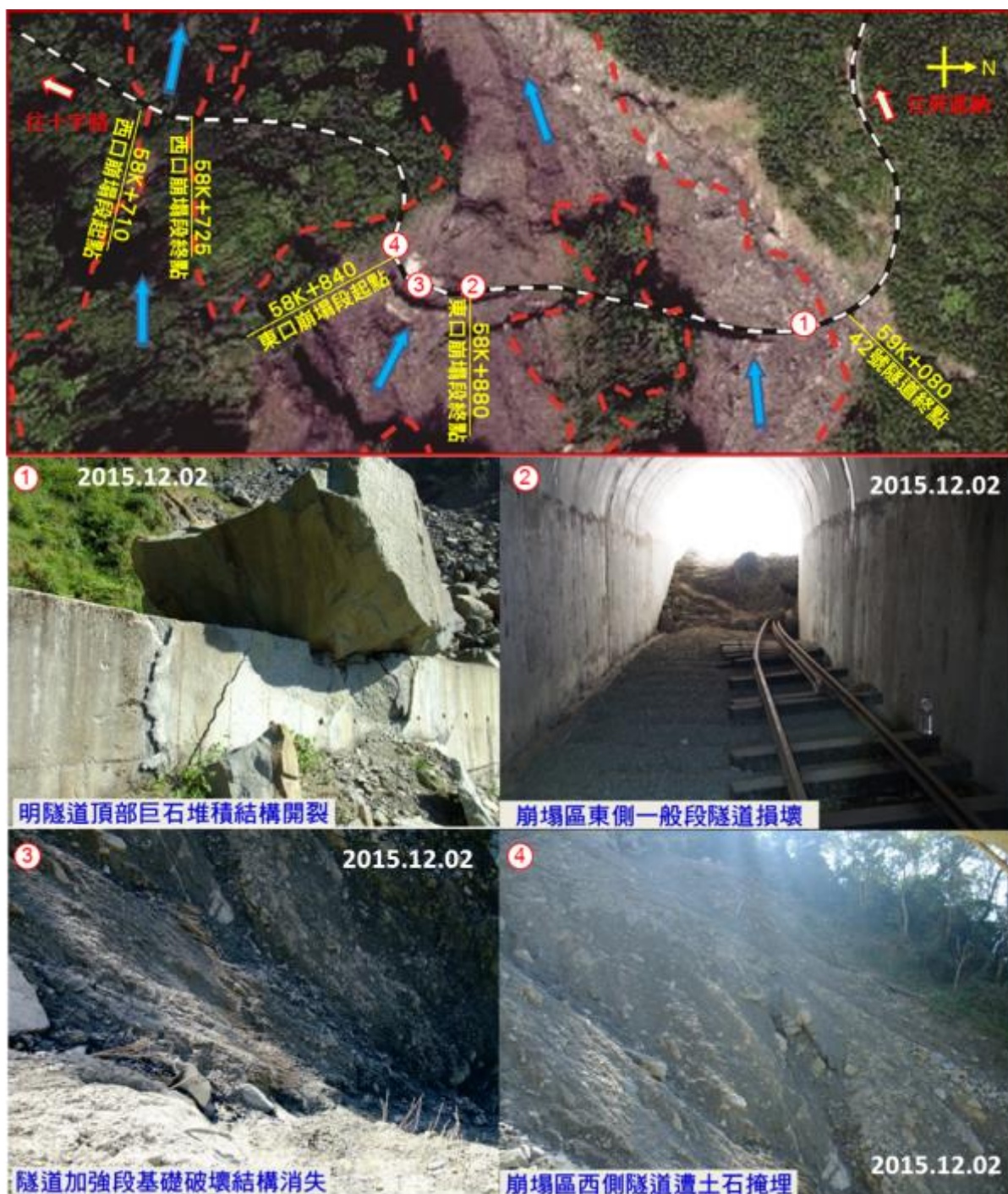
圖 2-2-1 42 號隧道東洞口崩塌地現況圖
