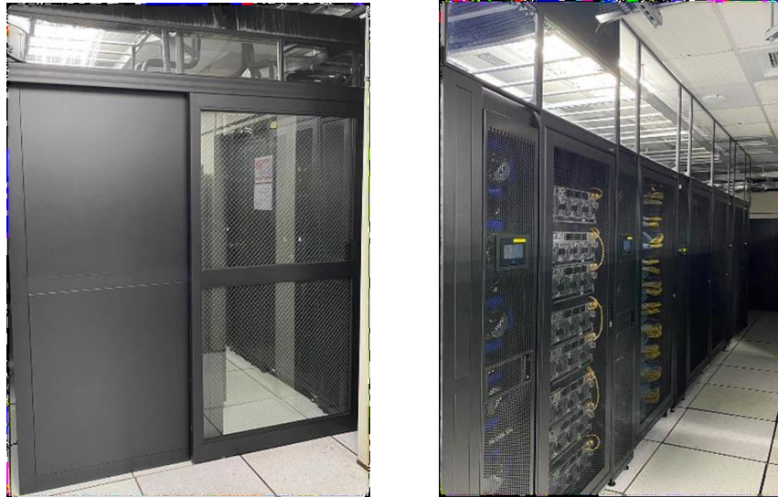
圖 5、6：112 年改善完成之機房熱通道封閉設備
