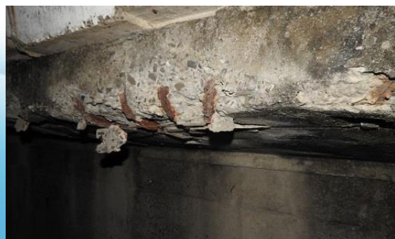
橋梁鹽害、混凝土剝落、 鋼筋嚴重鏽蝕
