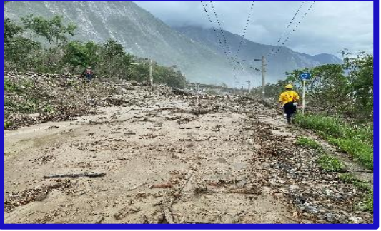
K56+620 土石流掩沒軌道
