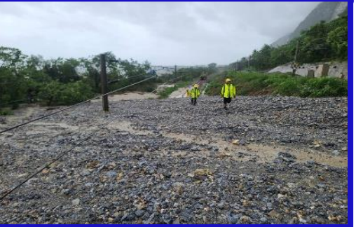
K56+820 土石流掩沒軌道
