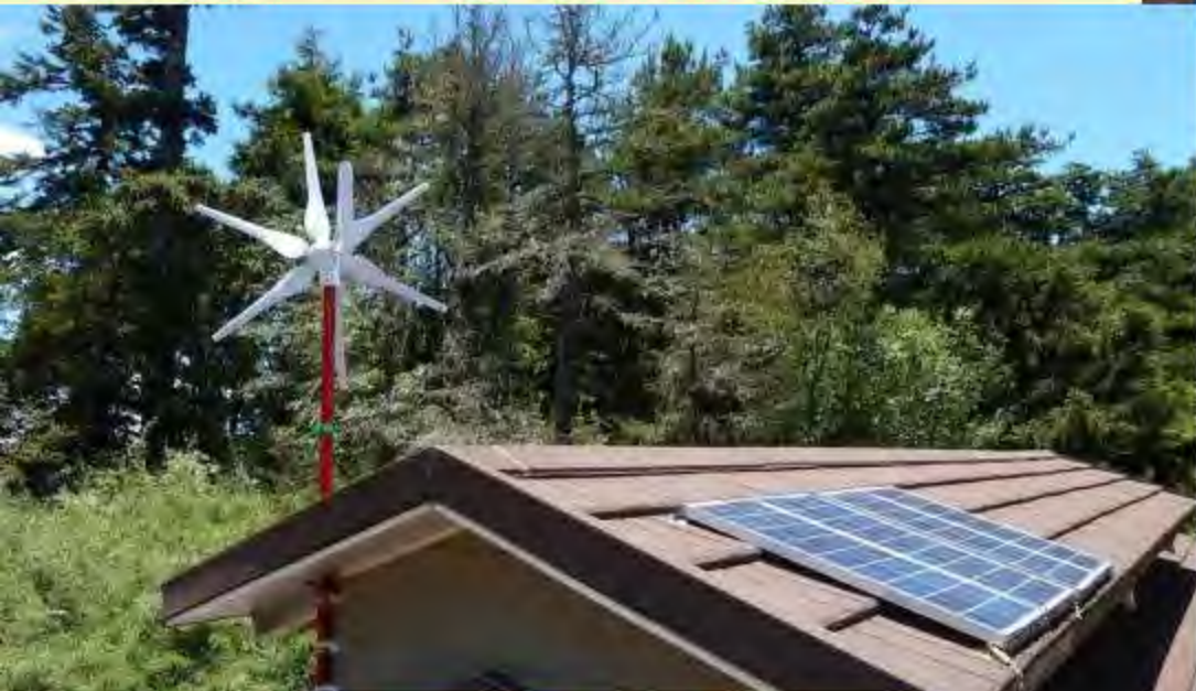
雲稜避難山屋的風力及太陽能發電
