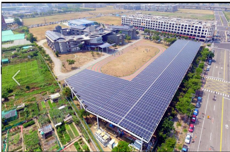
高雄市鳳翔國中風雨球場光電 設置容量 689.12kW，面積約0.7公頃。
