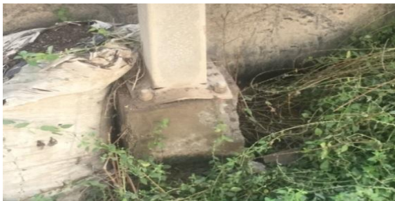
形鋼底板變形
