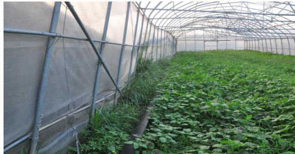
因基地土壤流失而損壞
