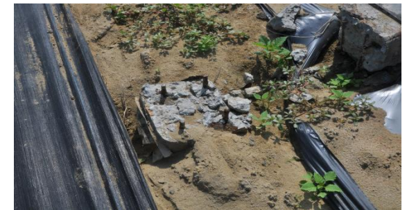
地基混凝土破裂
