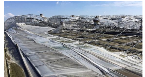
結構管材耐受力等級不足
