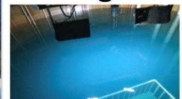
高雄大樹伏流水 (已供水)
