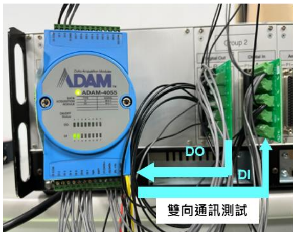
即時模擬器(區域電網能源管理系統)
