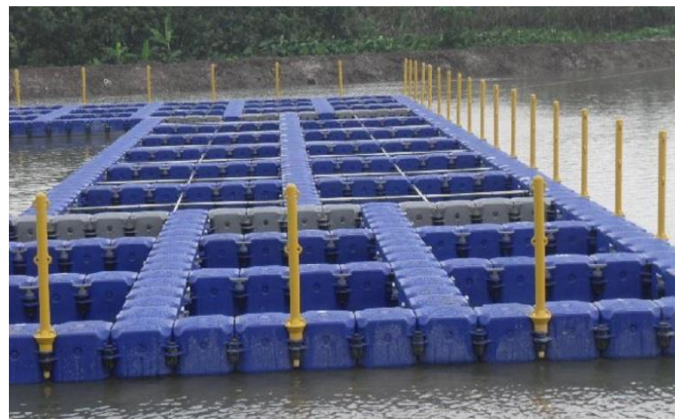
浮動式光電設施
